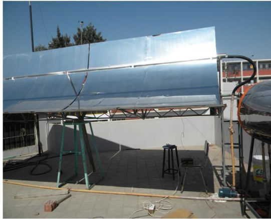
Figura 49. Instalación para la generación de vapor.
