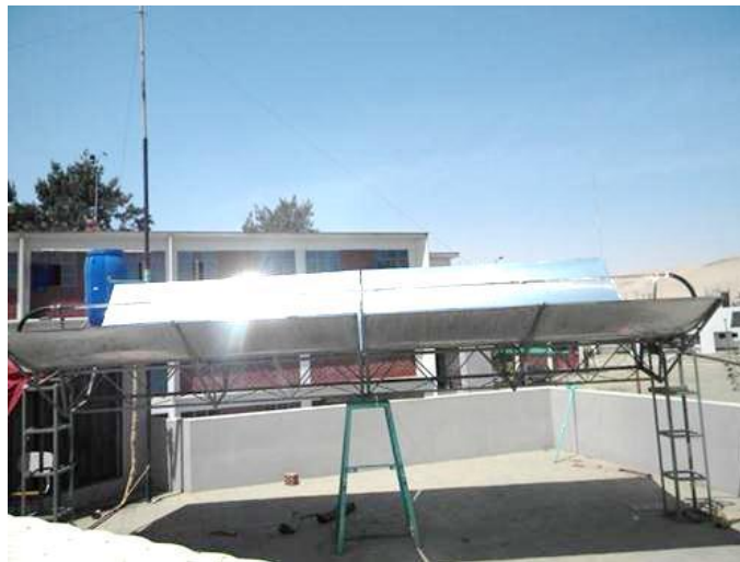
Figura 42. Ubicación de equipos para determinar la eficiencia óptica
