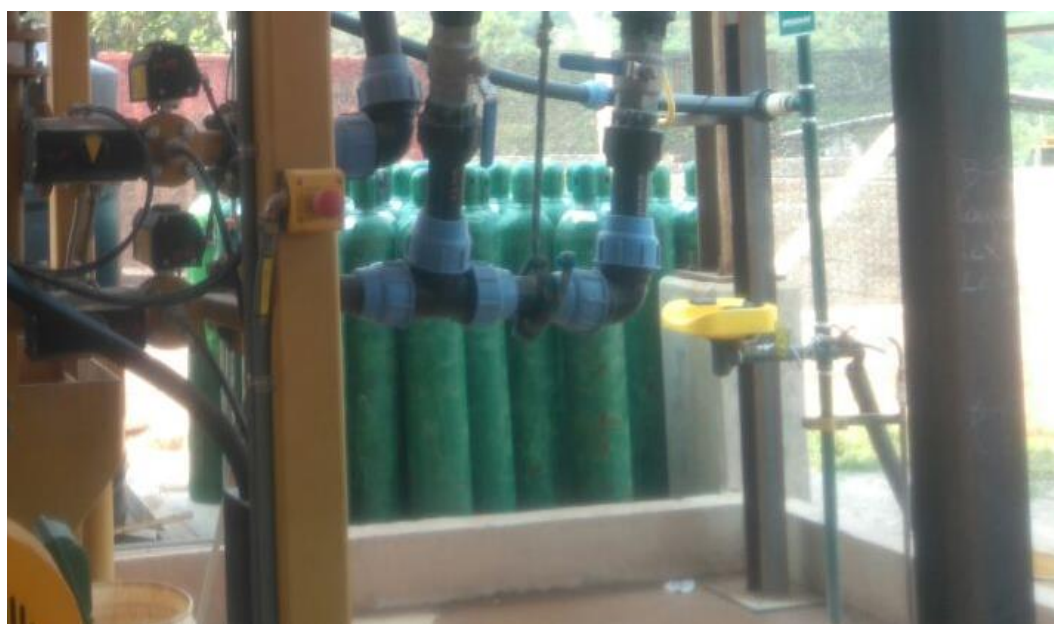
Figura 21. Disposición de tanques de oxígeno. Fuente: Elaboración propia.
