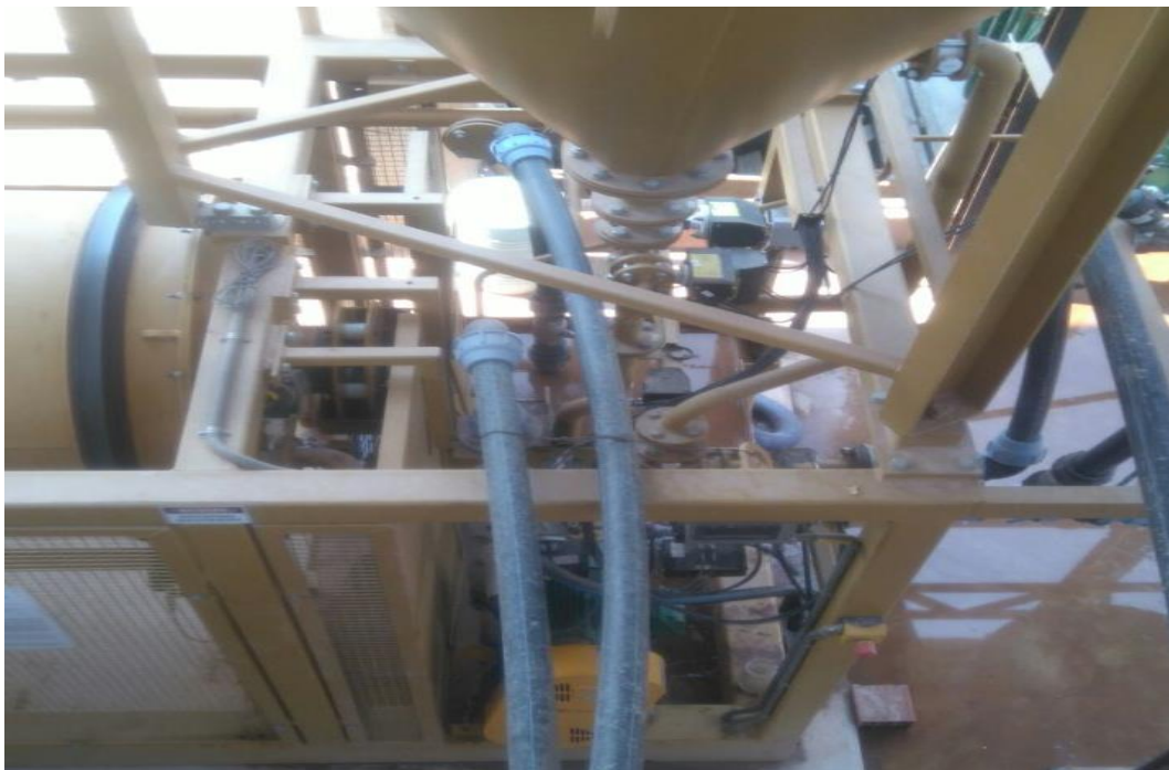
Figura 24. Entrada de agua al tambor del equipo Gekko ILR 150. Fuente: Elaboración propia.
