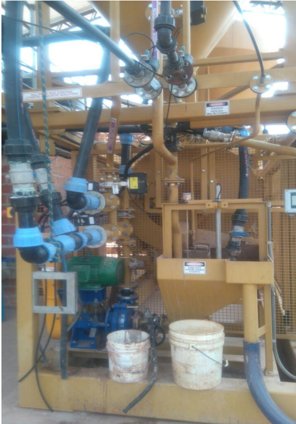
Figura 22. Conexiones y controles en la entrada del Equipo Gekko ILR 150. Fuente: Elaboración propia.
