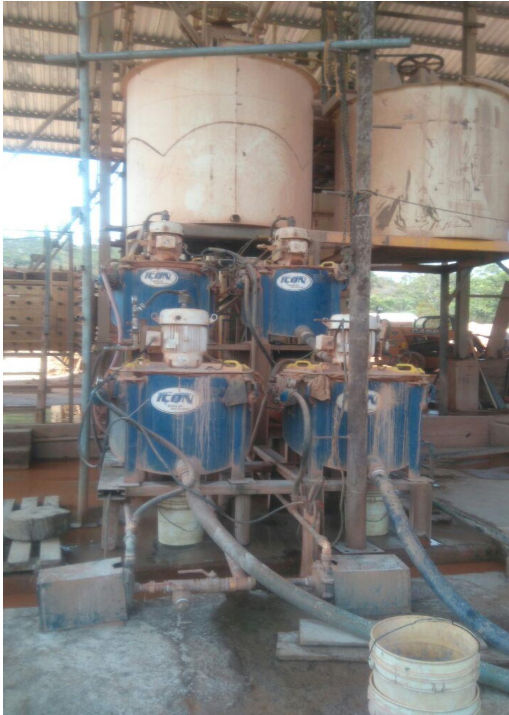
Figura 18. Disposición de banco de concentradores gravimétricos ICON. Fuente: Elaboración propia.
