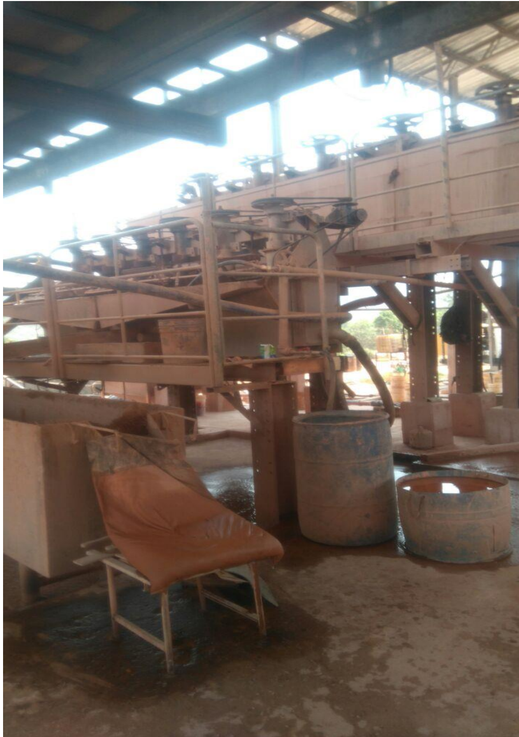
Figura 19. Disposición de banco de celdas de flotación. Fuente: Elaboración propia.
