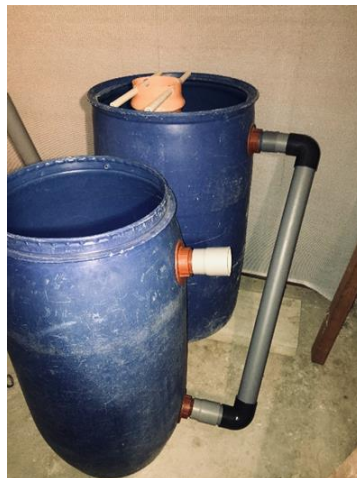
Foto 7: Instalaciones de tuberías.
