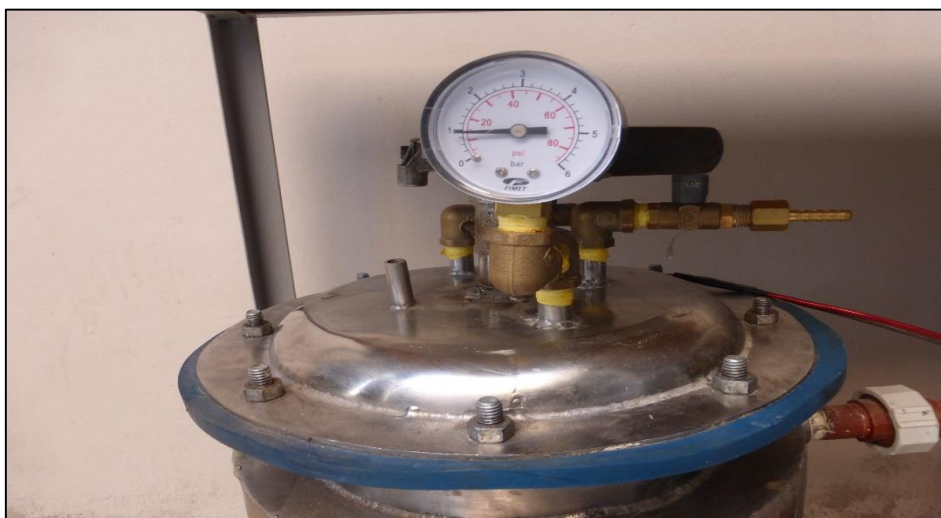
Figura 89. Manómetro de control de la presión en el biodigestor.
