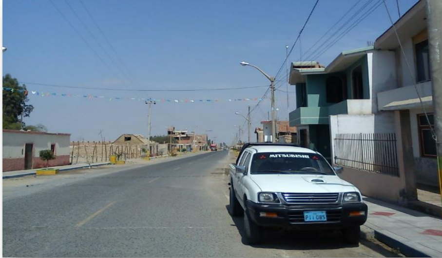
Figura 4 Desgaste a nivel de capa de rodadura.
