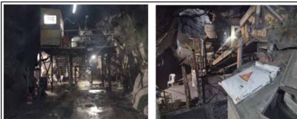
Figura 11. Planta dosificadora de concreto Fuente: Elaboración propia – Interior mina nivel 14.
