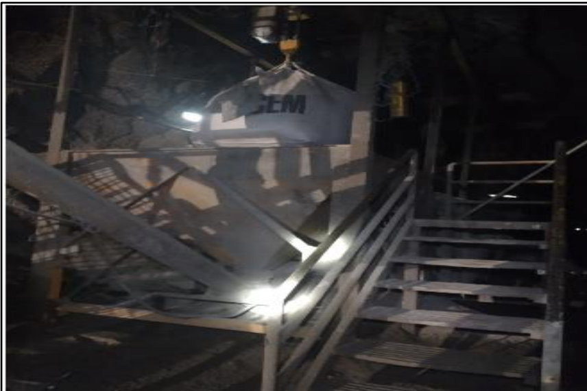
Figura 14. Tolva de cemento
