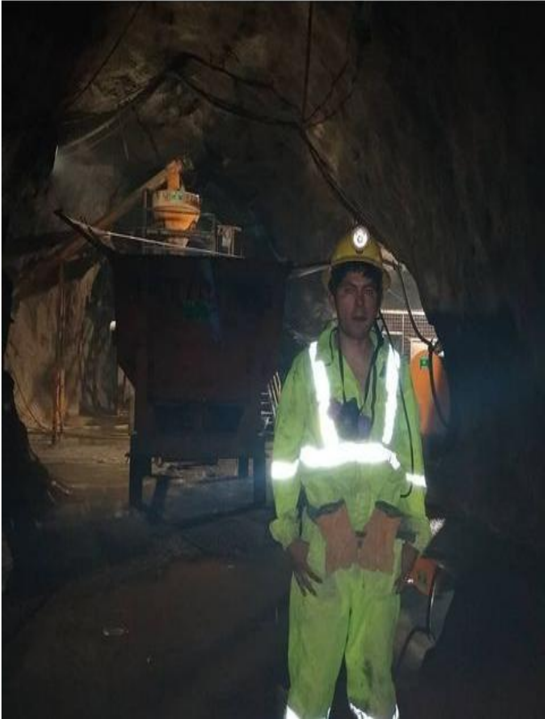
Anexo 7: Planta dosificadora de concreto interior mina nivel 14
