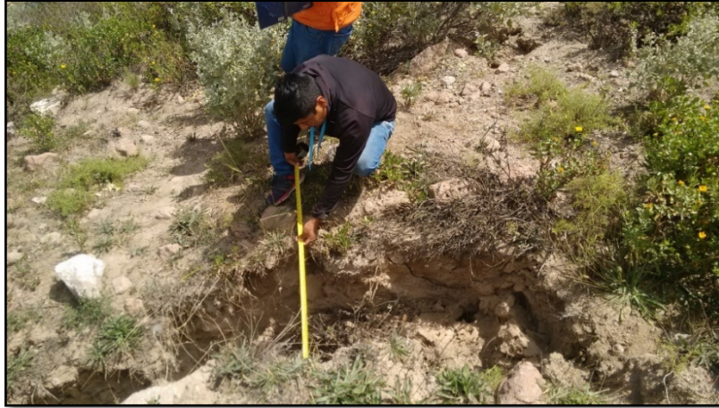
Figura 76: Grietas paralelas a escarpa de deslizamiento en sector de Matarani.
