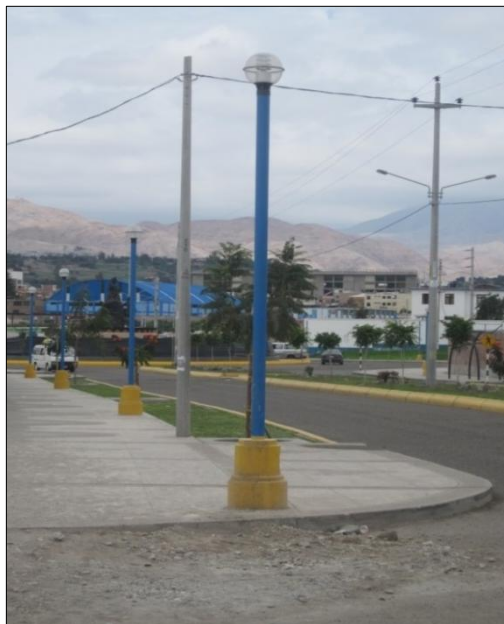
Figura 66. Alumbrado público en la av. Simón Bolívar
