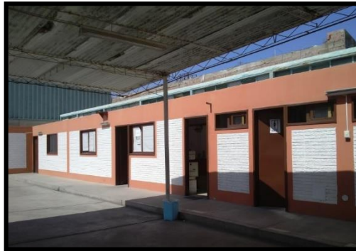
GRÁFICO N° 32 Área de Almacenaje: Almacén colapsado
