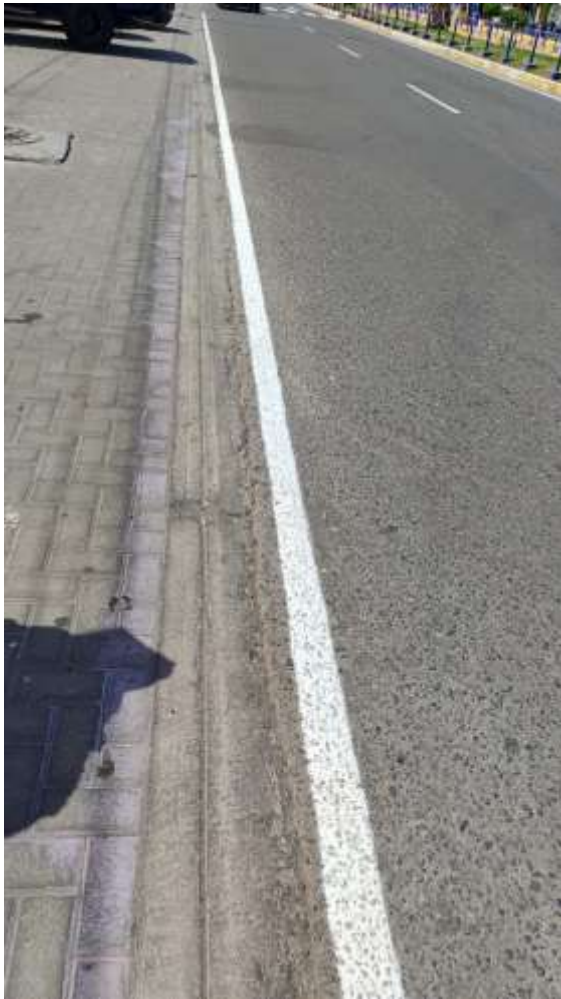
Fisura en Borde
