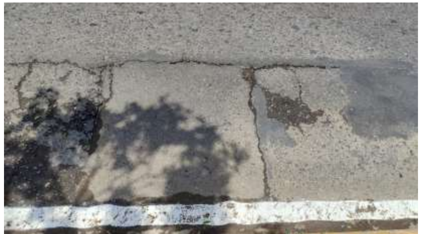
Fisura en Bloque
