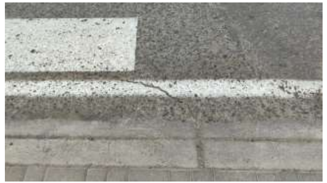
Fisura Transversal y longitudinal
