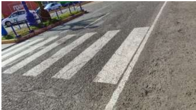
Fisura en Bloque
