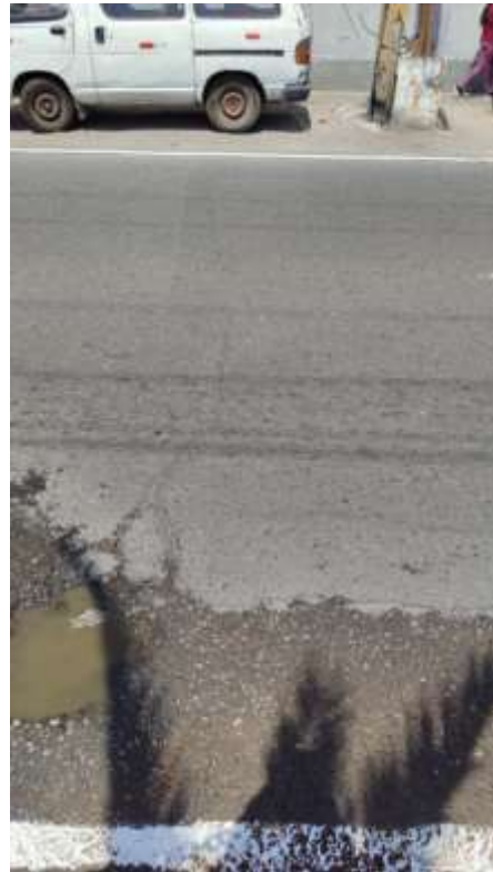
Fisura Transversal y Hueco
