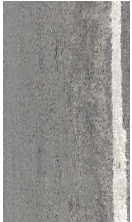
Desprendimiento de Agregados
