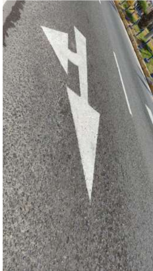
Desprendimiento de Agregados
