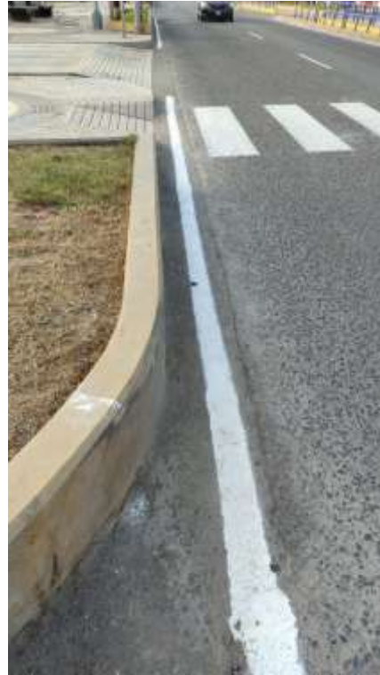
Fisura en Borde
