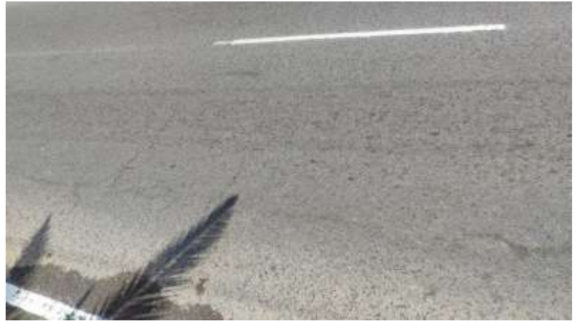
Fisura en Bloque
