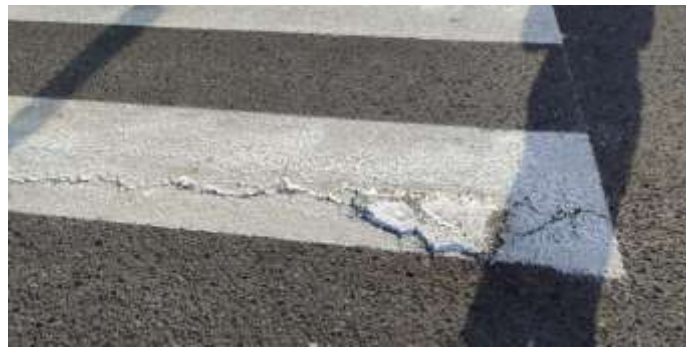
Hueco y Fisura Longitudinal
