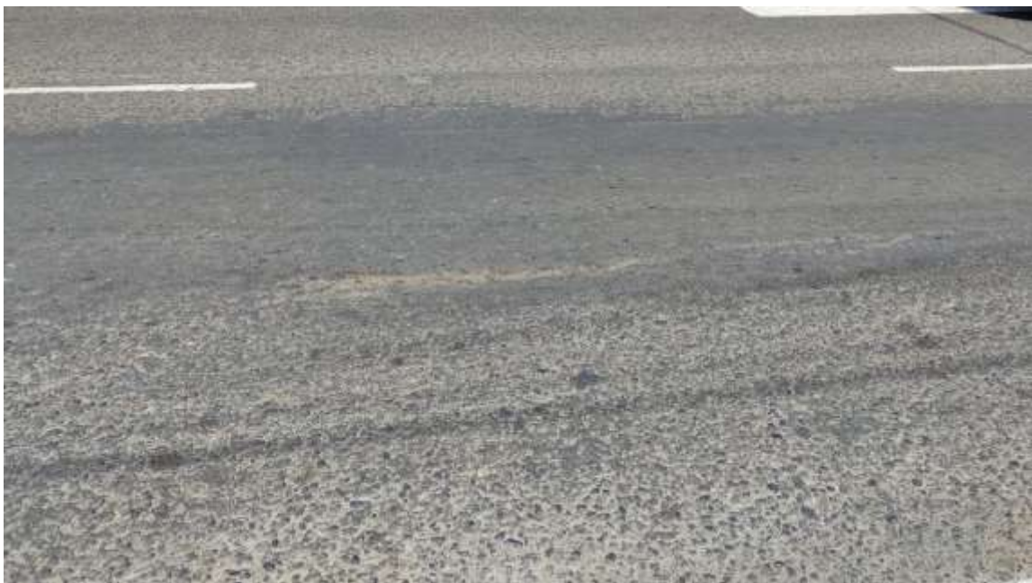
Fisura Longitudinal y Piel de cocodrilo
