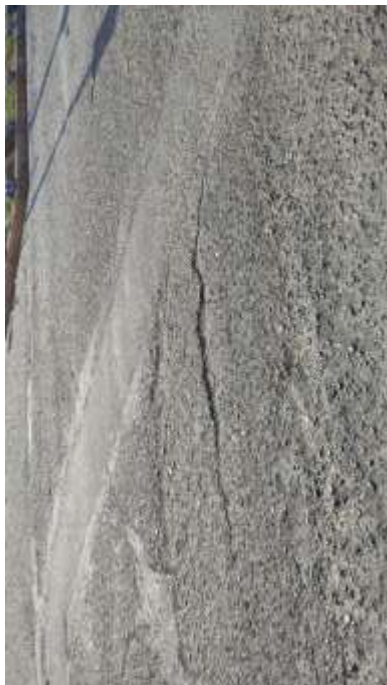
Fisura Longitudinal y Parcheo
