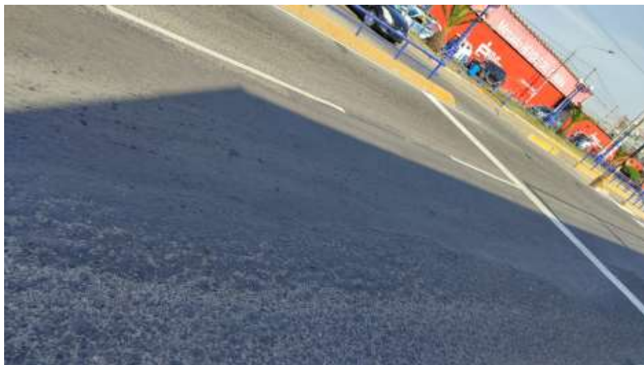
Piel de cocodrilo y desprendimiento de agregados
