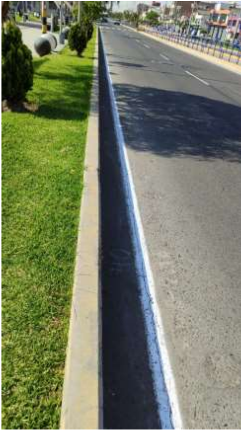
Fisura en Borde
