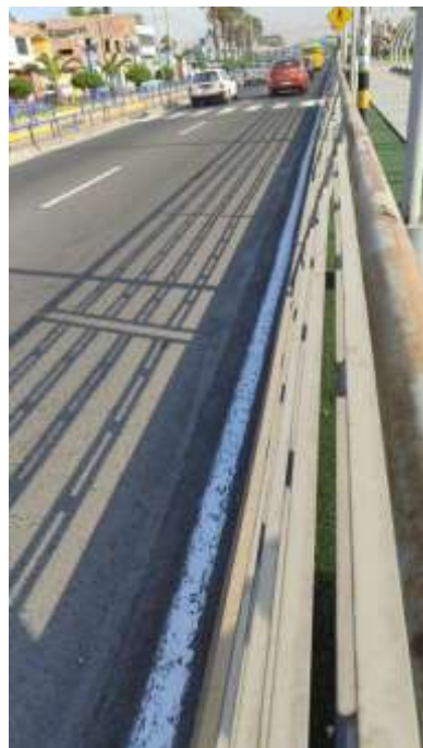
Fisura en Borde
