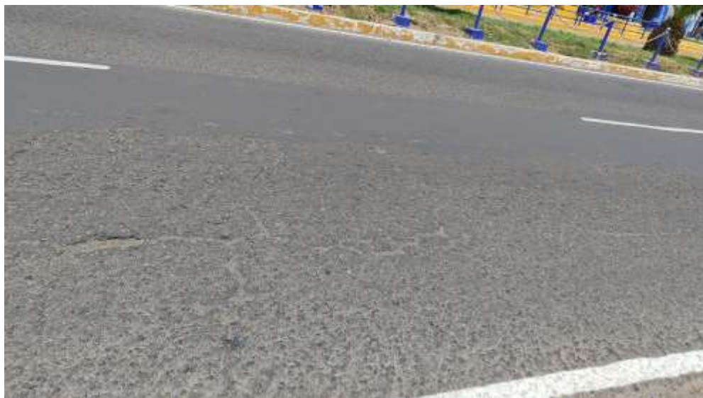
Fisura en Bloque
