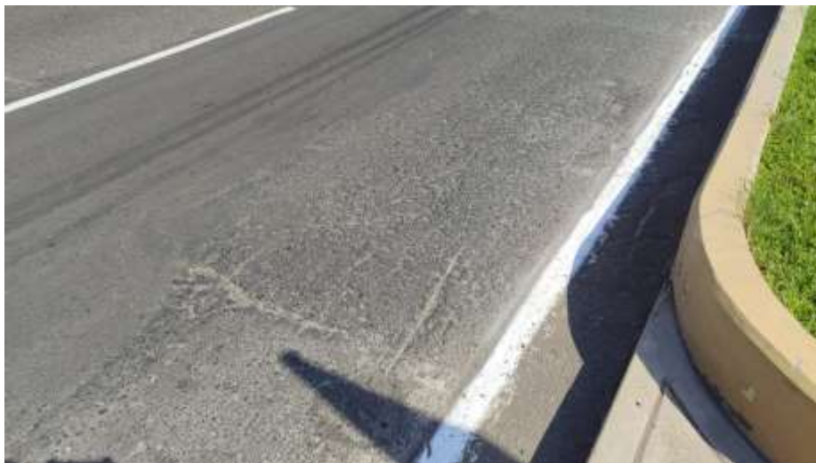
Fisura en Bloque
