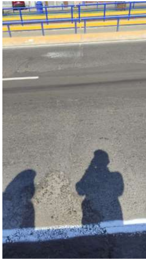
Hueco y Fisura Transversal
