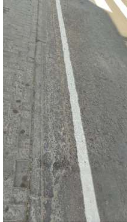
Fisura en Borde
