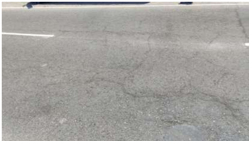
Fisura en Bloque
