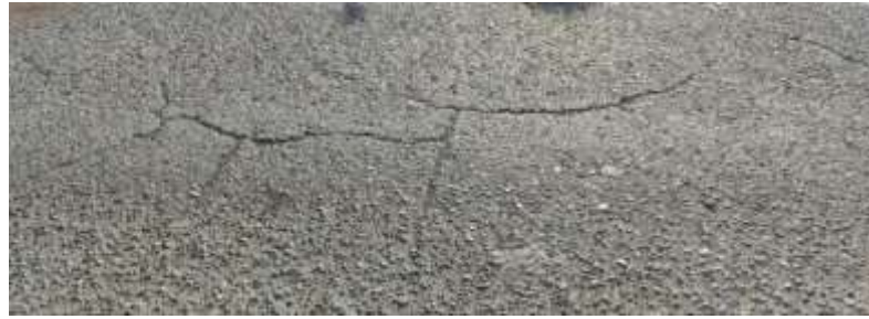
Fisura en Bloque
