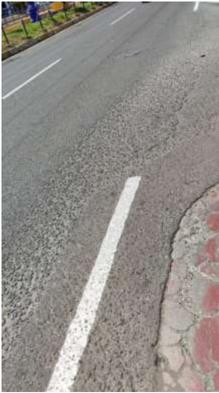
Desprendimiento de Agregados
