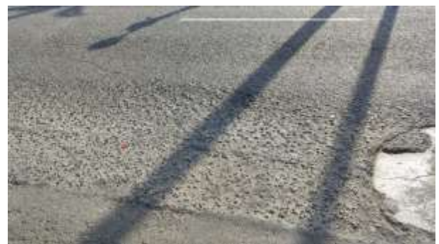
Desprendimiento de Agregados
