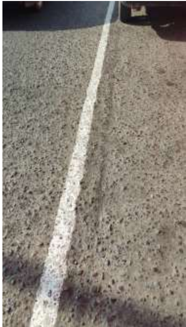
Fisura de Borde
