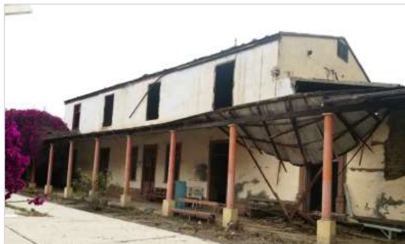
Figura 14. Estado actual del bloque A- vista frontal Fuente: Elaboración propia
