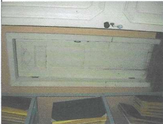
PUERTAS DESPINTADAS Y PISO APOLILLADO
