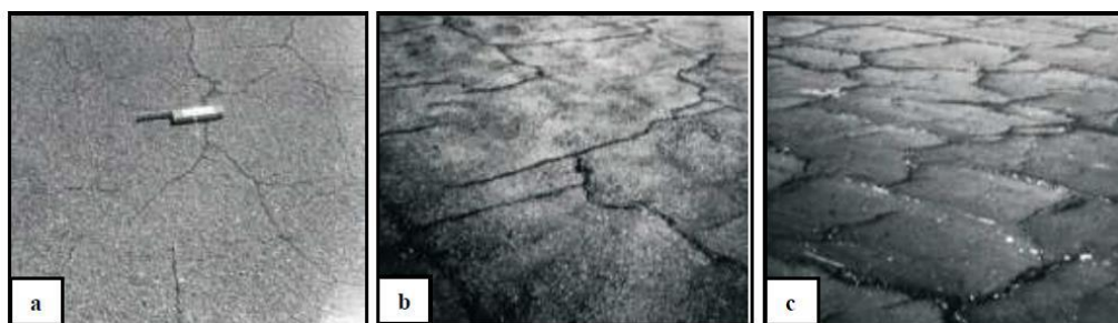
Figura 4. Agrietamiento en Bloque con distintos niveles de severidad. Fuente: (Vásquez, 2002)
