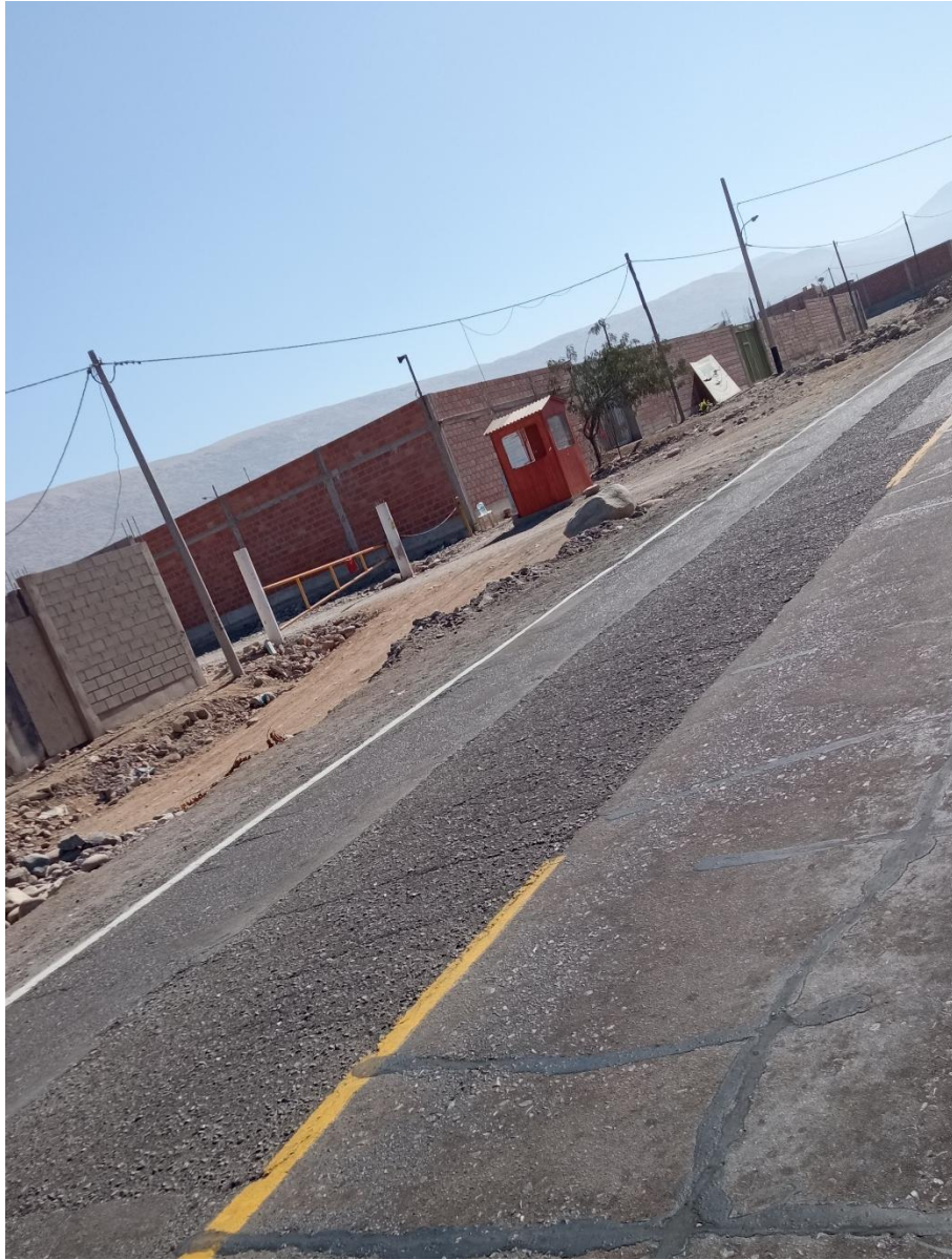
Fotografía falla tipo piel de cocodrilo de la vía de PE-40
