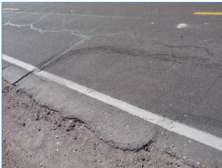
Fotografía de tipo de grieta parabólica de la vía de PE-40
