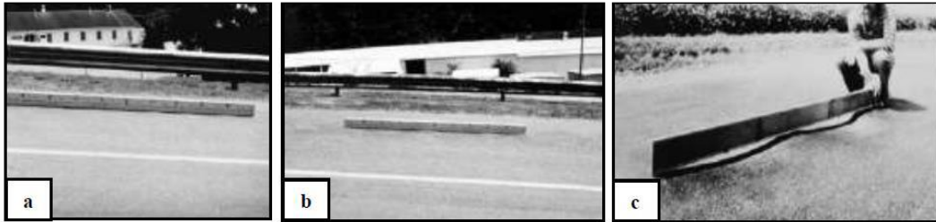
Figura 6. Corrugación con distintos niveles de severidad. Fuente: (ingepav, 2002)
