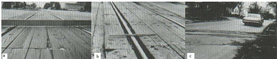
Figura 14. Cruce de vía férrea con distintos niveles de severidad. Fuente: (Vásquez, 2002)
