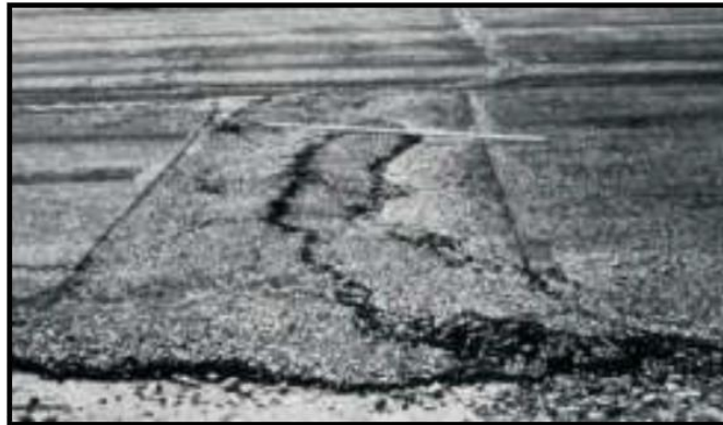
Figura 18. Hinchamiento severidad alta. Fuente: (Vásquez, 2002)
