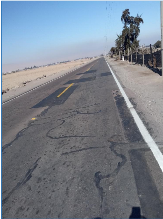
Fotografía de fallas tipo parcheo encontradas de la vía de PE-40
