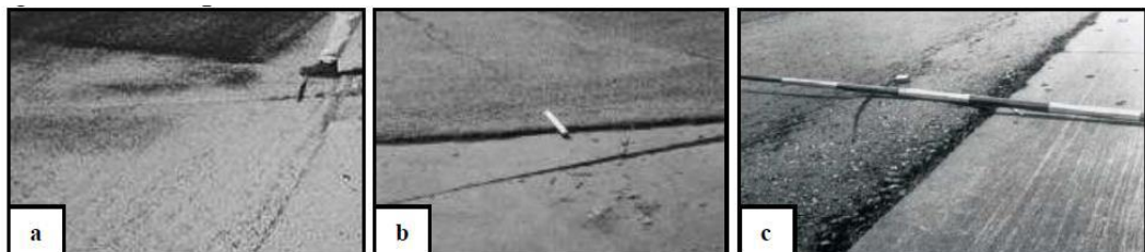
Figura 16. Desplazamiento con distintos niveles de severidad. Fuente: (Vásquez, 2002)
