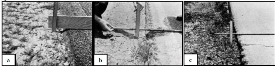
Figura 10. Desnivel de carril/berma con distintos niveles de severidad. Fuente: (Vásquez, 2002)
