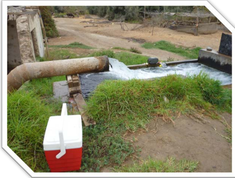
Foto 01: Pozo sin cubierta expuesto a contaminación
