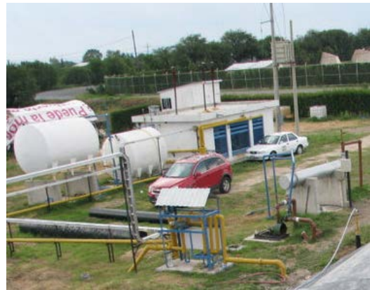
Reservorios de biogás (Fuente: Proyecto MOPESA).
