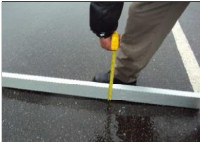
Figura 2.24. Medición de ahuellamiento.
