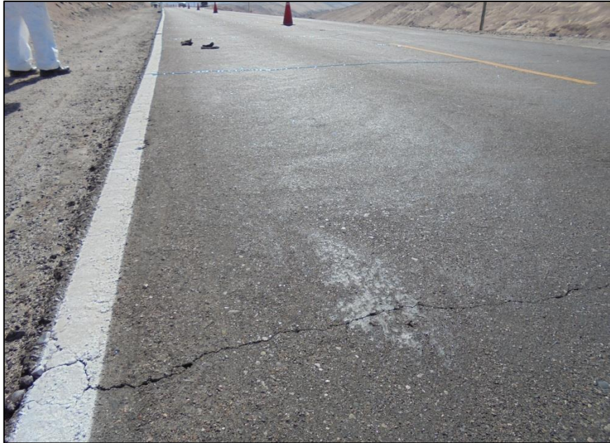
Figura 4.9. Se presentan fisuras de forma transversal km 23+000.
