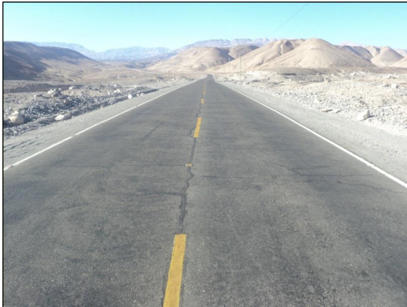
Figura 4.6. Se aprecia las fisuras tratadas en forma longitudinal y transversal km 12 + 000 al km 13+000.
