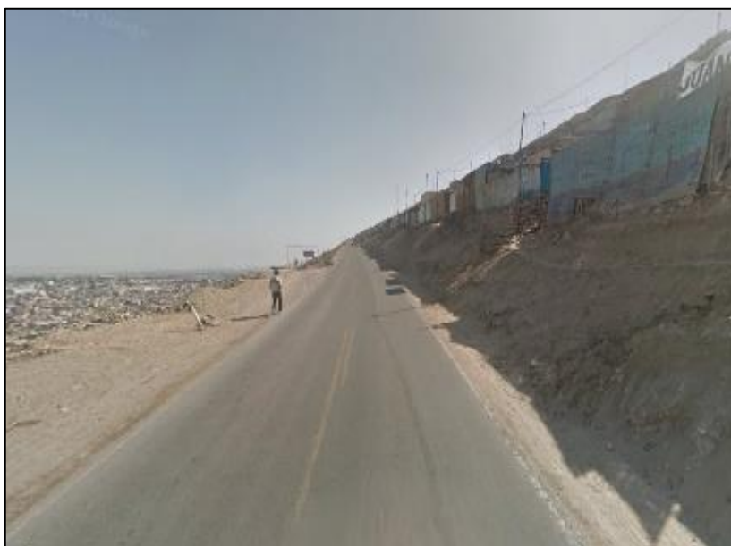
Figura 4.2. A la altura del km 02+500 se observa derrumbes debido al talud inestable, lo que produce que no se tenga berma.
