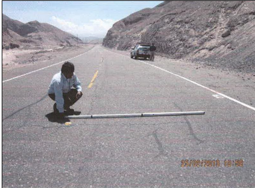
Figura 4.7. En el km 26+000, se presentan ahuellamientos notorios de hasta 10mm.
