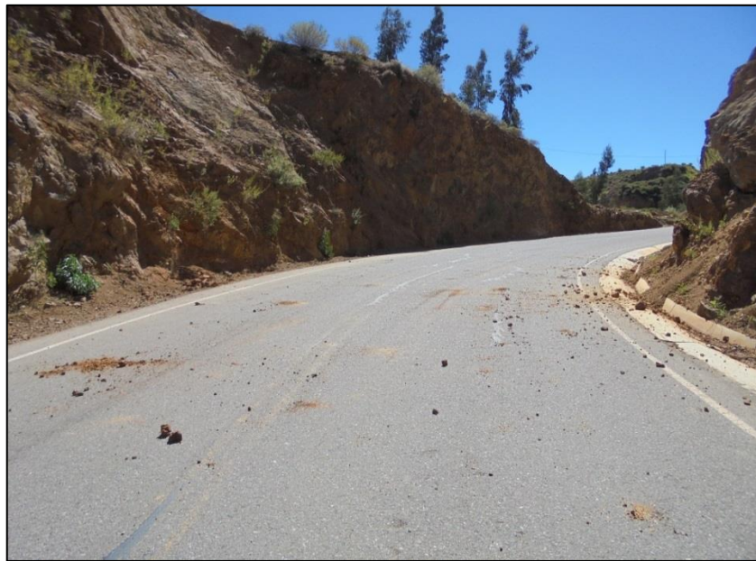
Figura 4.12. Nótese la carpeta asfáltica desgastada y con resane km 80+000. (Derrumbes menores)
