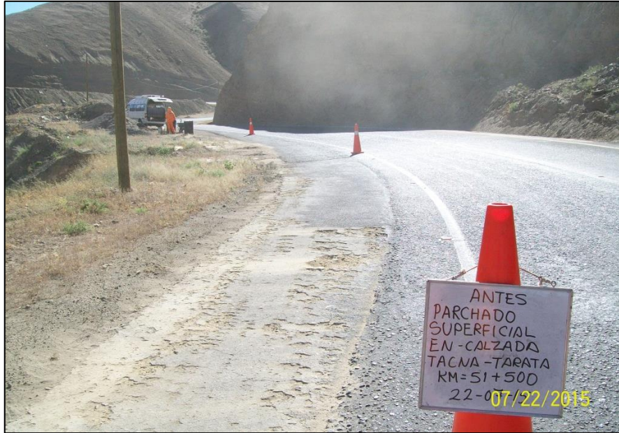
Figura 4.11. Bermas en mal estado carcomiendo la carpeta asfáltica km 51+500.
