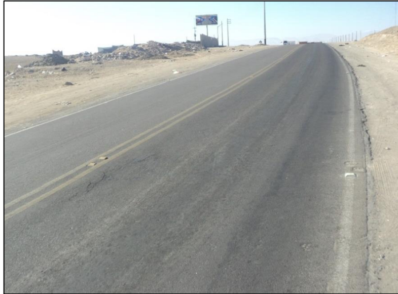
Figura 4.3. Se observa la carretera desgastada y con ahuellamiento. (bermas carcomidas)
