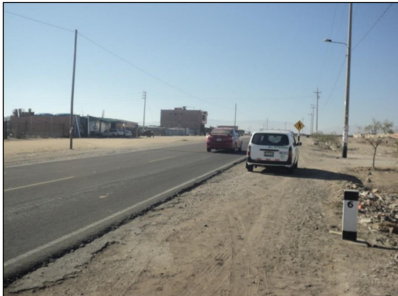
Figura 4.4. Entre el km 05+000 al km 06+000, se observa como la Berma ha erosionado y desgastado casi en su totalidad.
