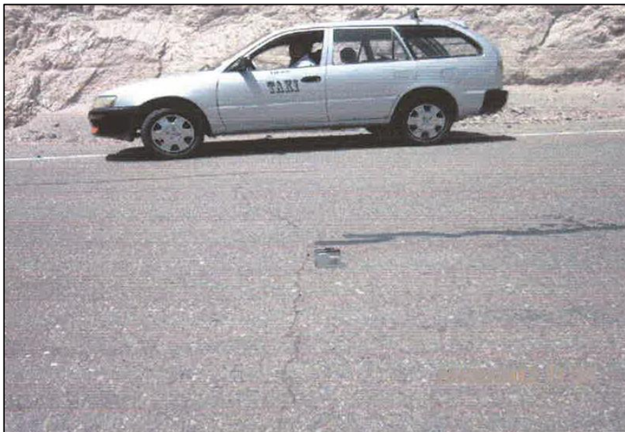
Figura 4.10. Se presentan fisuras de forma transversal y fisuras resnadas km 28+500.
