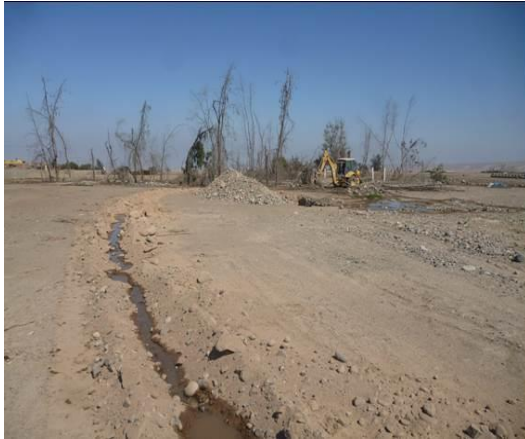
Figura 32: Conducción efluentes a zona de reúso
