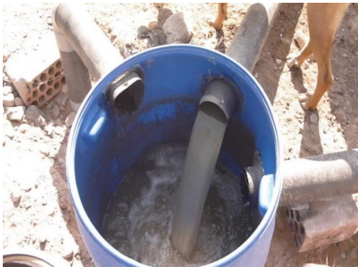
Figura 10. Captación de agua con tubería 4"
