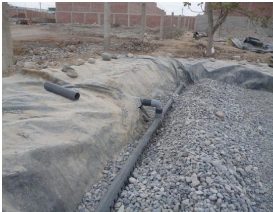
Figura 35: Tuberías de 4" PVC cribadas
