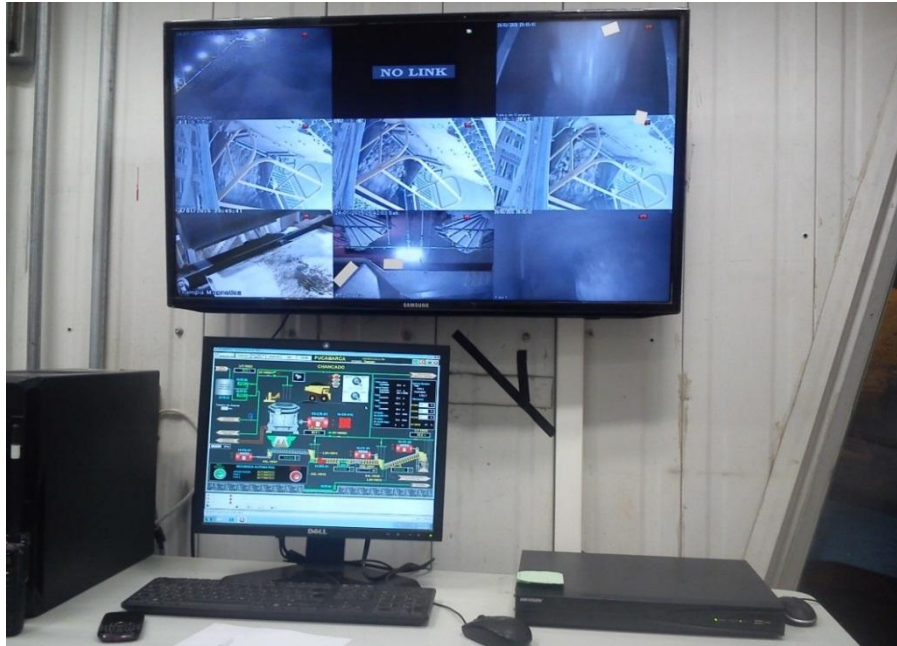
Figura 24. Cámaras en la cabina de control
