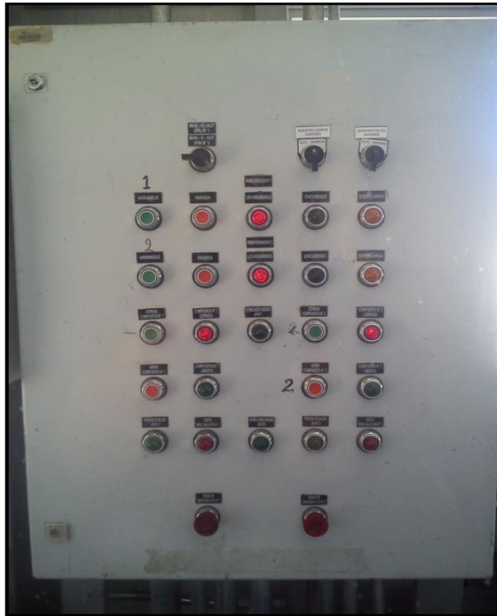
Figura 12. Tablero eléctrico de control
