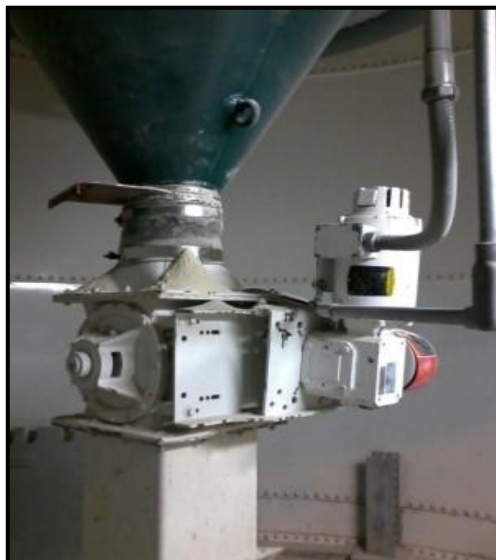
Figura 10. Fluidizador de cal y válvula rotativa
