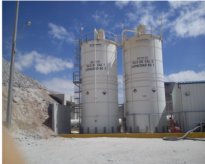
Figura 09. Silos de cal
