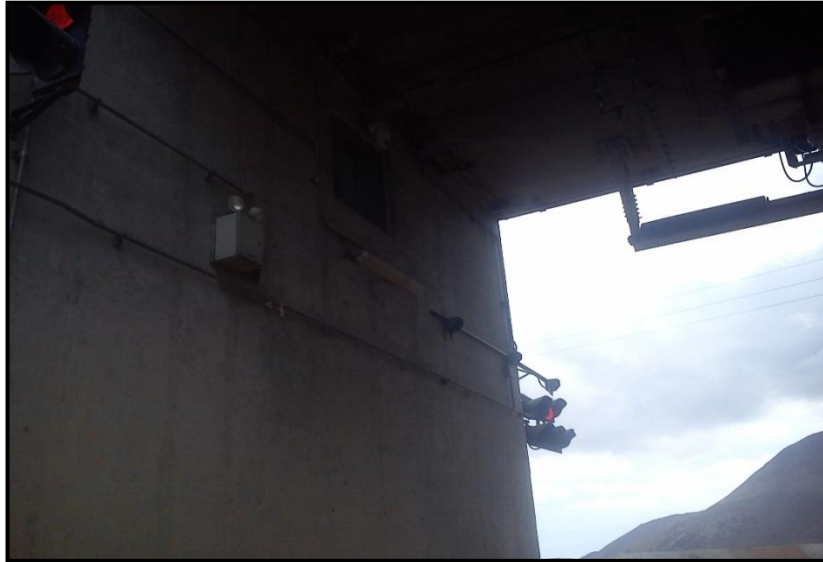
Figura 22. Ubicación de las cámaras en el circuito y tolva Ore Bin (1)
