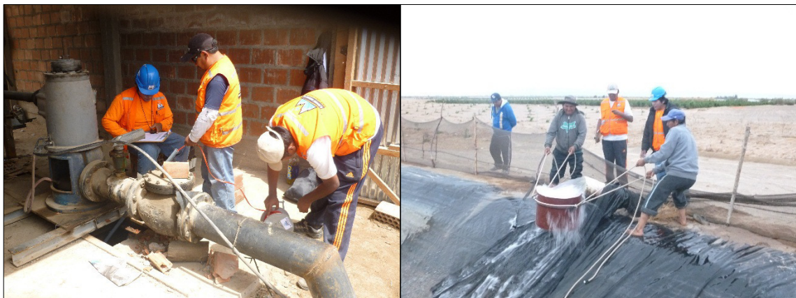
Foto 15 y 16: Medición de niveles de descenso en el pozo N°03 de la Asoc. 4 Suyos (Coordenadas UTM WGS-84: 346123 Este y 7985776 Norte) y medición de caudales por el método volumétrico, mediante el uso de un cilindro calibrado y un cronómetro.
