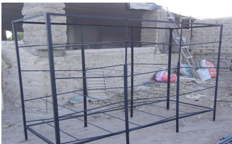
Vista de estructura metálica para bandejas
