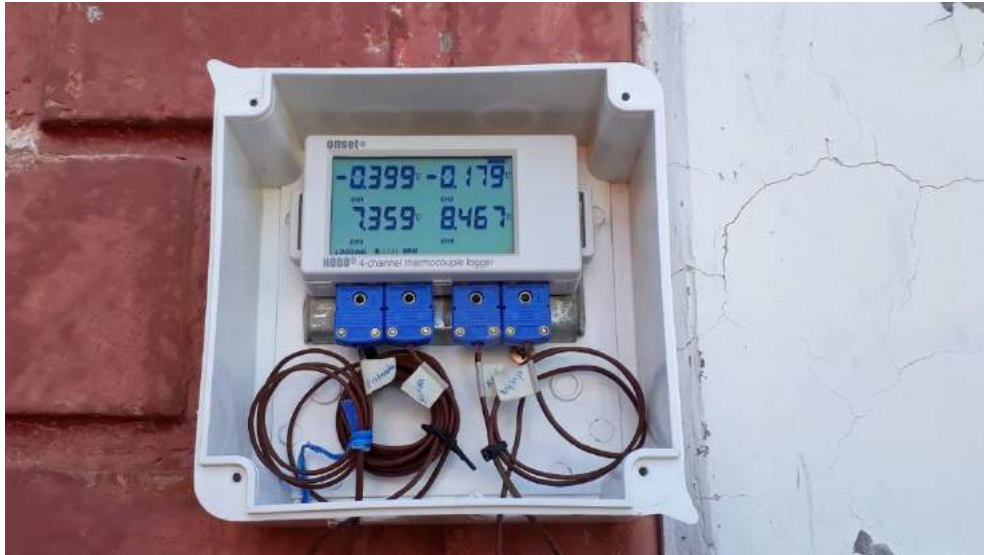
Figura 67. Sensores de temperatura que registran las temperaturas en puntos interiores del termotanque conectados al datalogger HOBO 1
