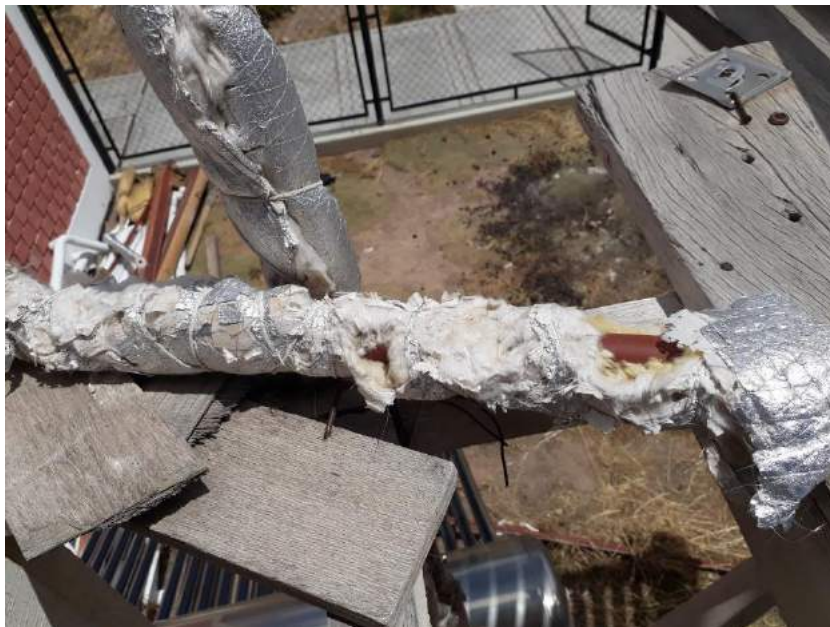
Figura 64. Estado inicial de las tuberías. El aislamiento térmico se encontraba en malas condiciones.
