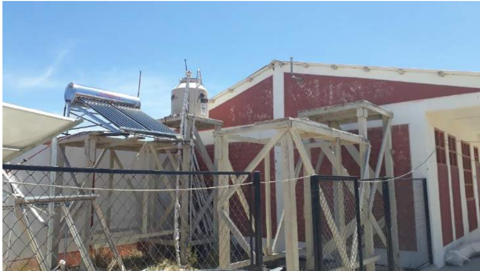
Figura 65. Estado inicial de la terma solar. Mala orientación geográfica.
