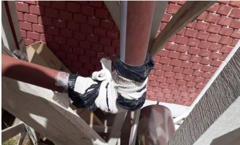
Figura 63. Estado inicial de las tuberías. Las rupturas en las tuberías causadas por el congelamiento del agua fueron parchadas con plástico y tela.
