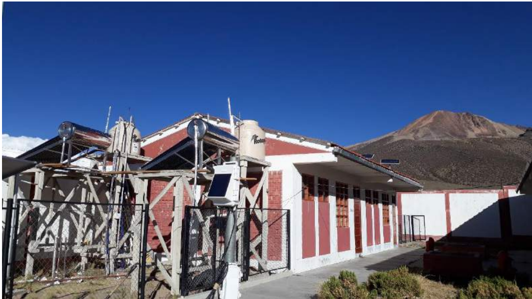
Figura 73. Ubicación de la terma solar con tubos de vacío
