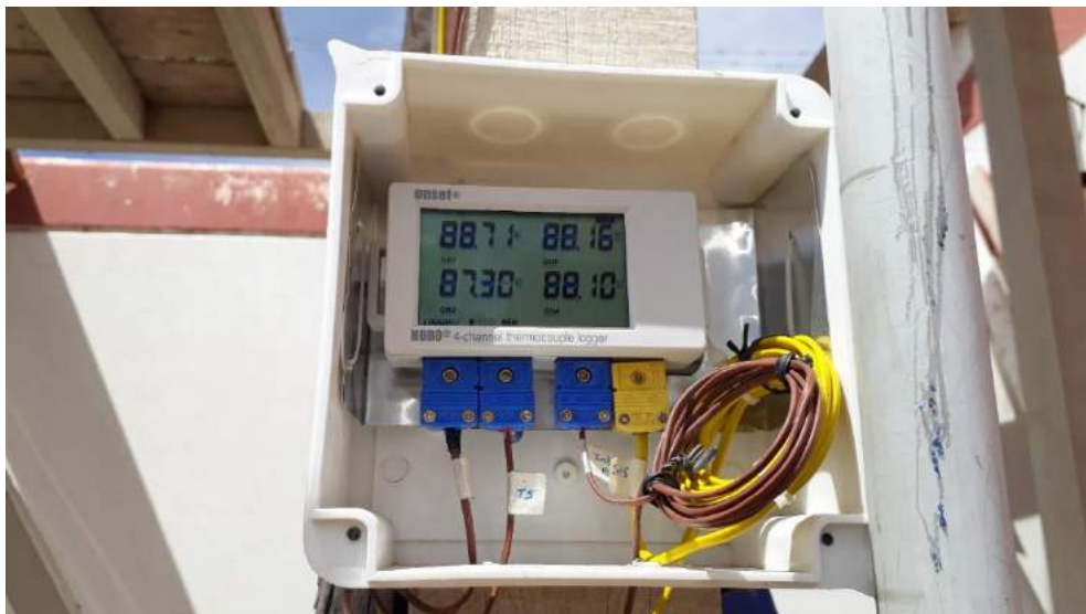
Figura 68. Sensores de temperatura que registran las temperaturas en puntos fuera del termotanque conectados al datalogger HOBO 2.
