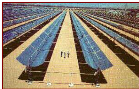
Figura Nº. 46 Paneles Solares Fuente: Internet
