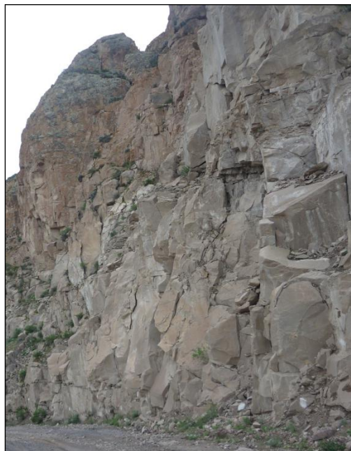
Figura 3.8. Vista en el km. 126+100 de los afloramientos volcánicos de la formación Huaylillas, los taludes se encuentran fracturados, presentando roturas tipo cuña y planares.
