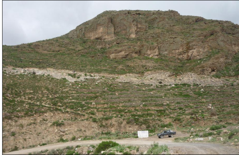
Figura 3.6. Se observa en el km. 125+500 al 125+670, depósitos coluviales, de una altura aproximada de 10 m. de potencia
