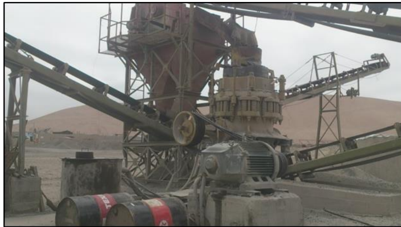
Imagen N°08: Planta de chancado de la M.P.T.
