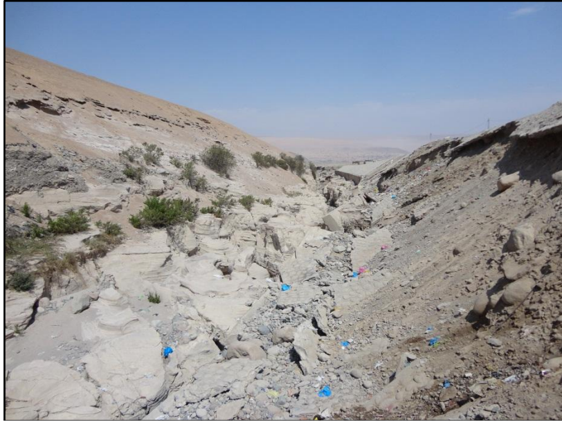
Foto N°16. Se observa la roca arenisca en la margen izquierda erosionada por la fuerza de la corriente.
