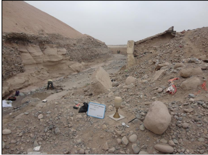
Figura N°13. Colapso de muro progresiva 0+480 margen derecha.
