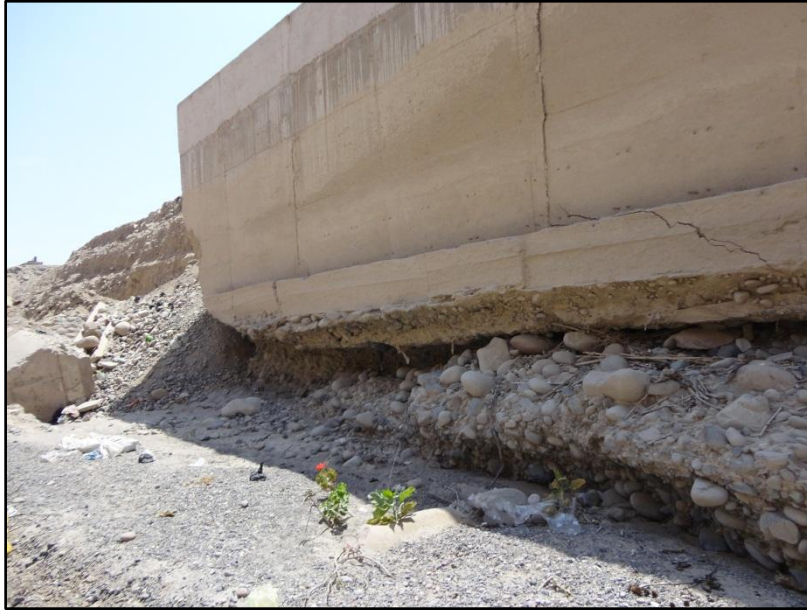
Foto N°12. Grado de Socavación General en campo es 0,84 m. en promedio.
