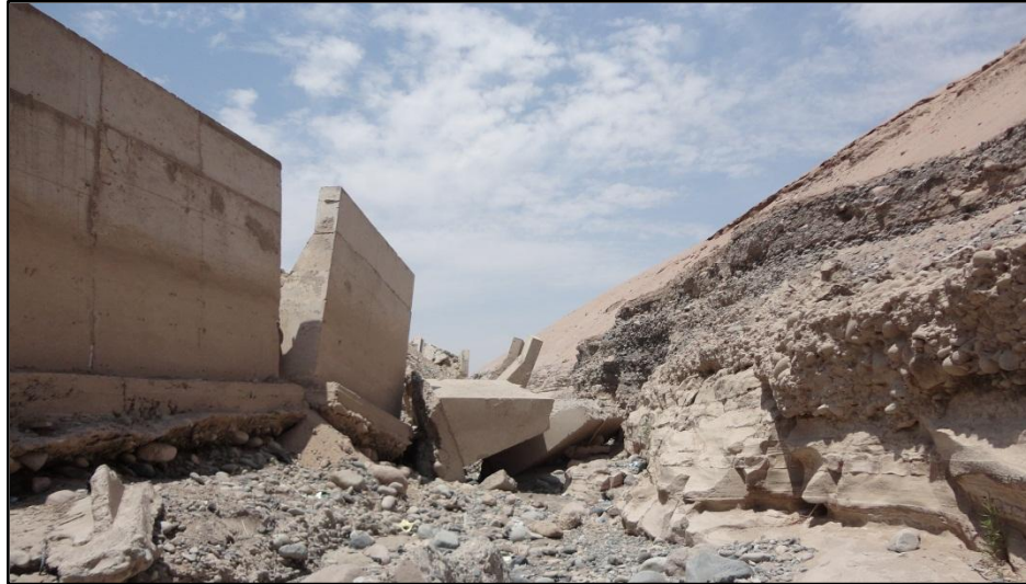
Foto N°19. La vista muestra el colapso de los muros en la zona del lecho inactivo progresivas 0+670 y 0+680 se calculó un incremento de base de lecho de 1,61m.
