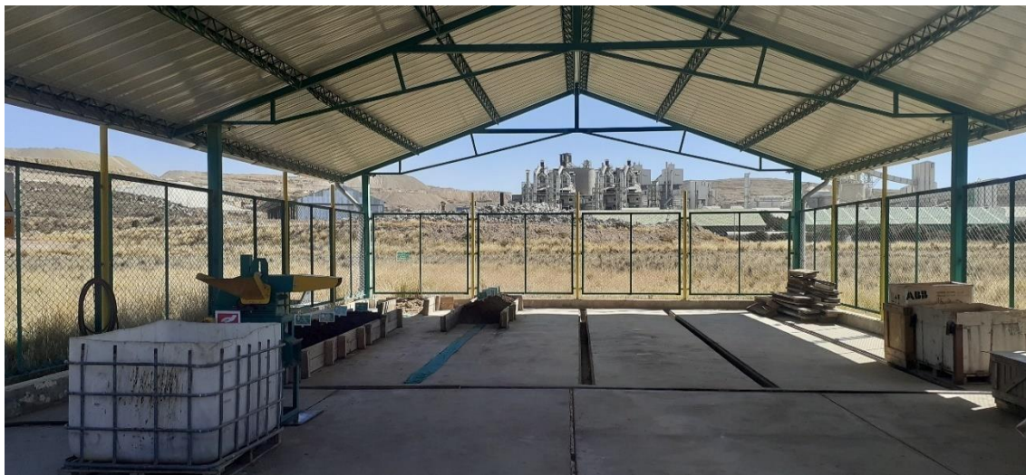
Planta de valorización de residuos sólidos orgánicos crudos
