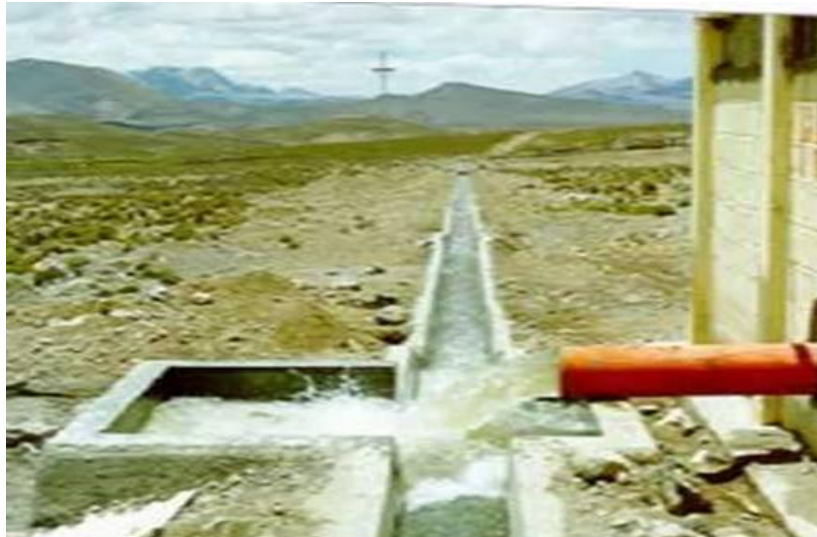
Figura 1: Obras hidráulicas, pozo subterráneo de extracción de agua
