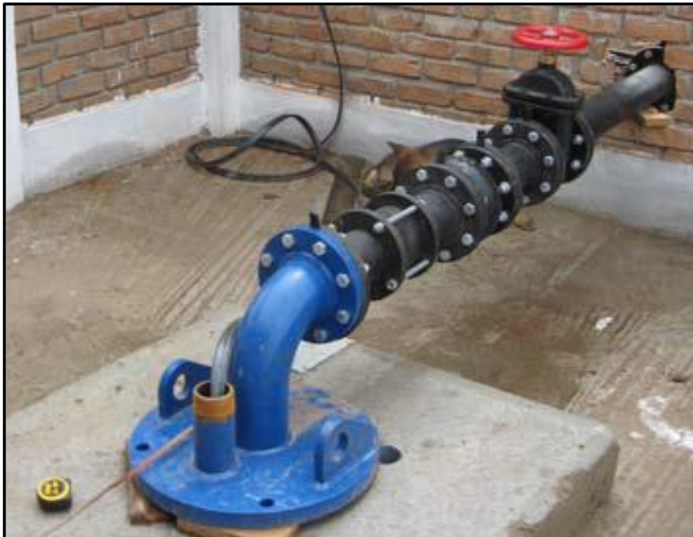
Figura 27. Codo de descarga y árbol de descarga
