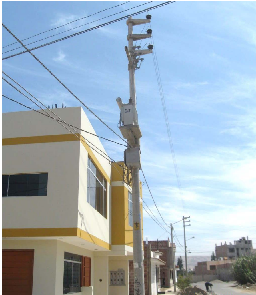
Figura N° 15: Ejemplo de una deficiencia correspondiente a la tipificación 2024 (Subestación de distribución incumple distancia de seguridad respecto a una edificación).
