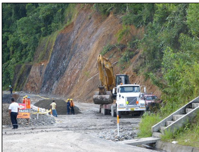
FOTO 1. Constantes reparaciones de sectores de la Carretera Interoceánica, tramo IV.
