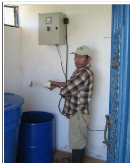
Figura 3. Sistema generador de hipoclorito de sodio
