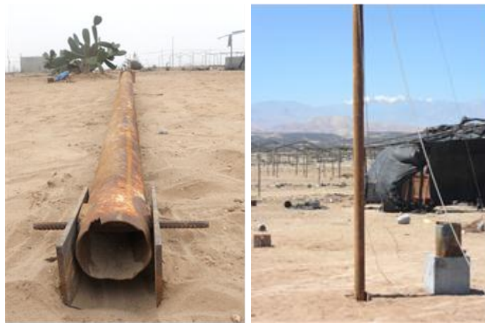
Figura 18. Torre construida con Tubo de fierro de 4" de diámetro. Ubicada en el lugar de evaluación.
