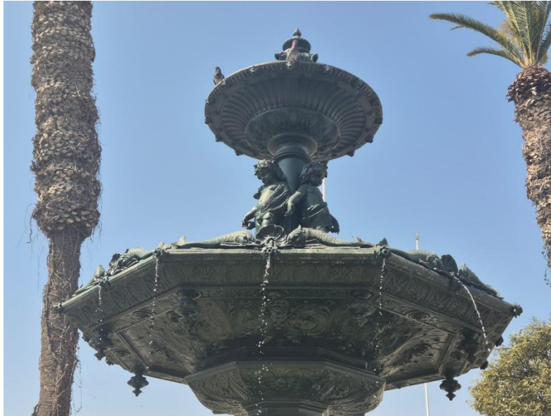
Foto 5: En la imagen se aprecia la materialidad de la Pileta Ornamental. Esta es Granito con un recubrimiento de Pintura Color Verde Oscuro.
