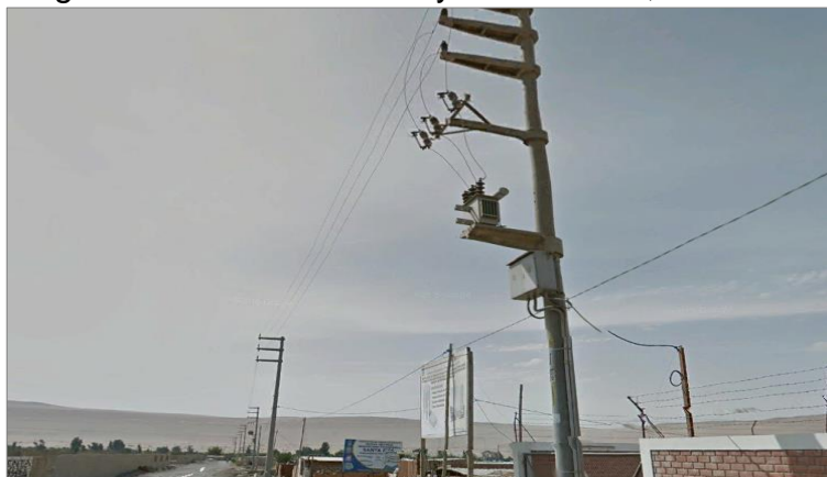
Imagen 30: Poste de Media y Alta tensión, Av. Vilauta
