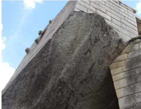
Figura 37. Ausente de mortero o argamasa superficial, muro externo del Templo del Sol
