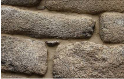
Figura 40. Ausente de mortero o argamasa superficial, muro externo del Templo del Sol
