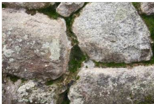
Figura 41. Ausente de mortero o argamasa superficial, Muro externo del Templo de
