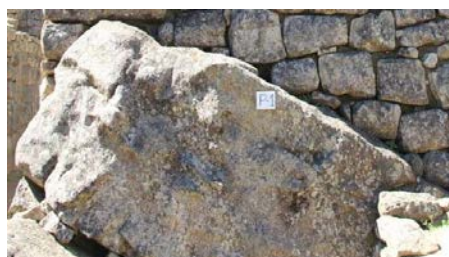
Figura 27. Estado piedra natural, Recinto Occidentales Superiores
