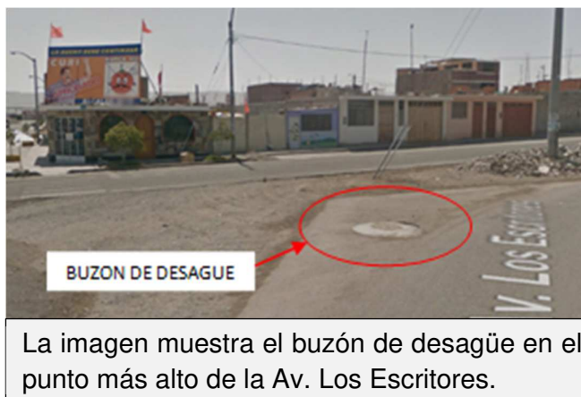
Figura N° 68: Desagüe del terreno intervención
