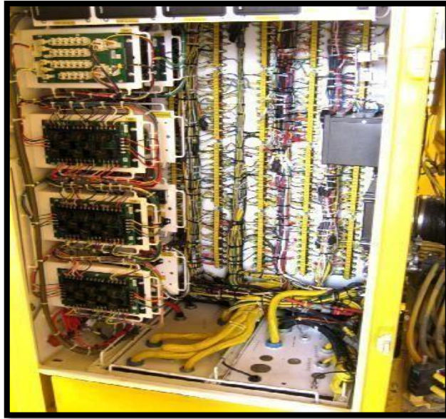
Figura 40: Gabinete de control ruteado
