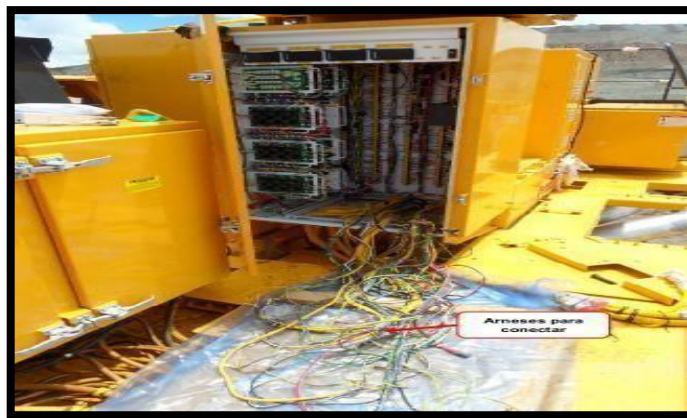
Figura 39: Ruteado eléctrico de gabinete de control
