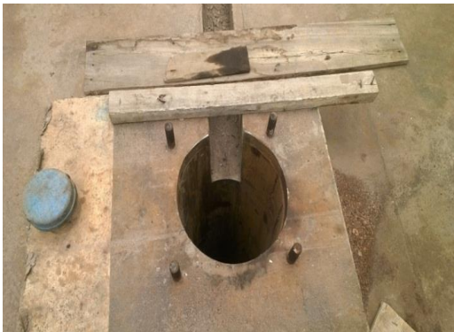
CONDICIONES DEL POZO 4
