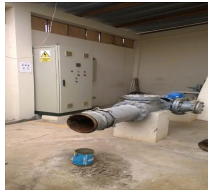
TUBERIA QUE CONECTA CON EL POZO 4
