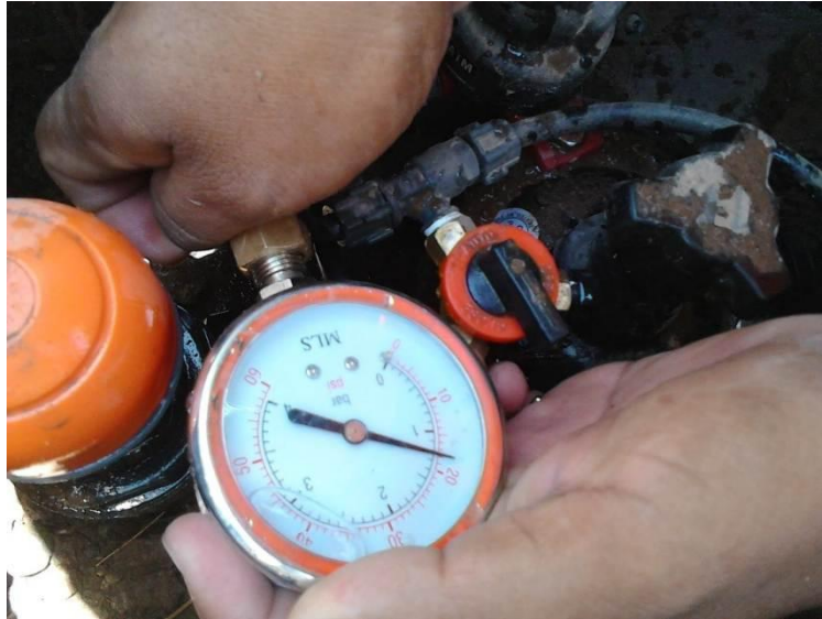
Foto 5. Medición de la presión de salida del arco de riego.
