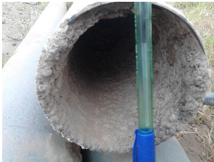
Fotografía 14. Presencia de carbonatos las paredes internas de la tubería matriz de 4".
