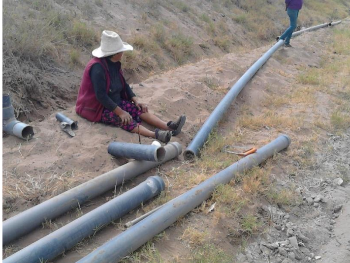
Foto 13. Desenterrado de tubería matriz de 4" con 6 años de antigüedad.
