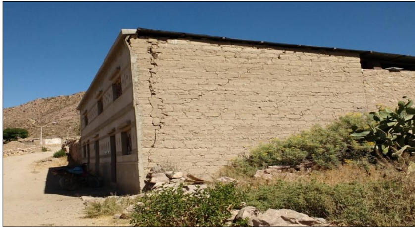
Foto 4.5 Evaluación de daños en infraestructuras en la localidad de Talaca.
