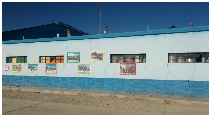
Foto 8.15 En la localidad de Aricota se aprecia las fallas en la pared del colegio.
