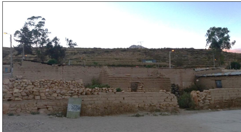
Foto 8.12 Localidad de Totora, se observa viviendas colapsadas, y de adobe.
