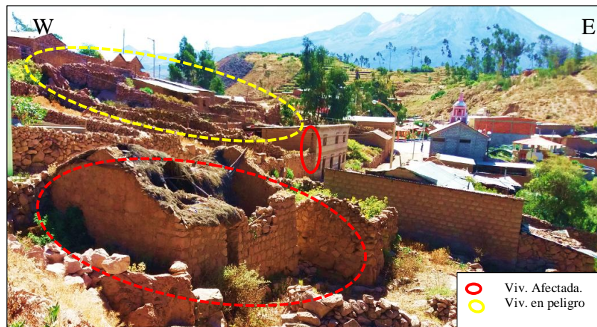
Foto 8.5 Localidad de Talaca, se muestra las viviendas afectadas del último sismo, asimismo, el peligro latente por el tipo de construcción de viviendas.
