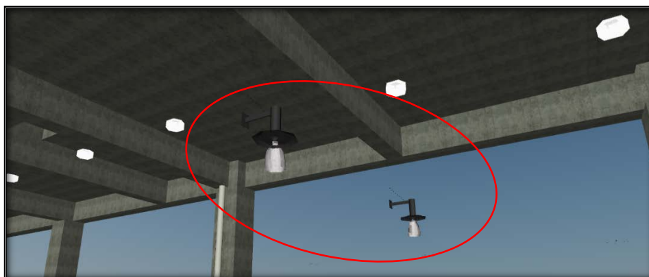
Imagen 21: Incompatibilidad pared – luminaria en el primer nivel del hotel 3 estrellas Fuente: Elaboración propia
