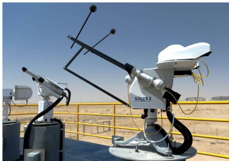
Figura 25. Seguidores solares Kipp & Zonen SOLYS instalado en Arabia Saudita (Recuperado de: http://proyectorfse.mx/2015/11/11/como-es-una-estacion-de-medicion-solar/ , 2016)
