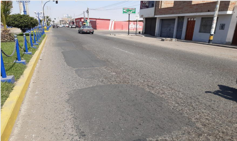
Figura 4 Presencia de parchado en la Av. Municipal.
