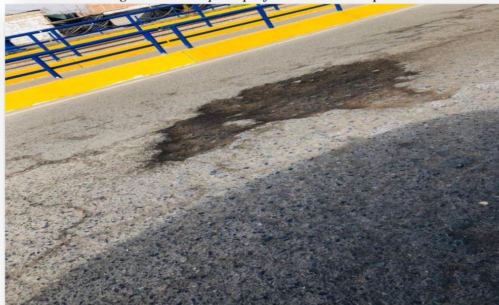
Figura 5 Presencia del desgaste en la capa superficial Av. Municipal.
