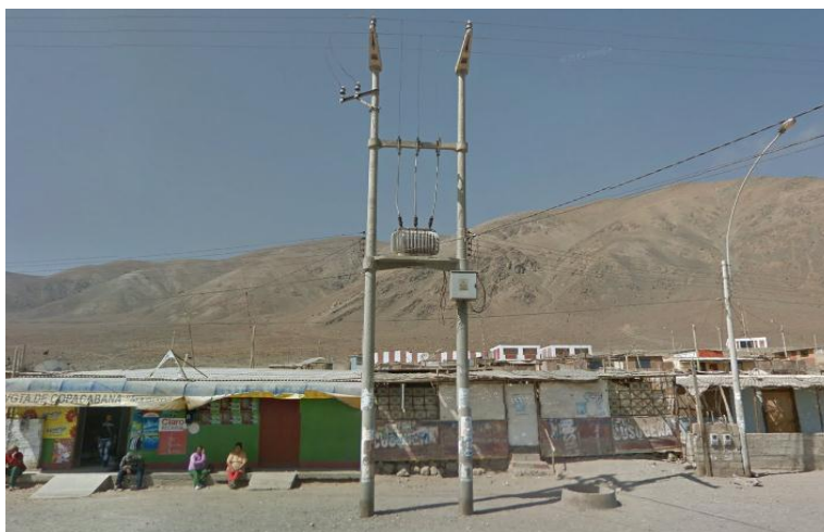
IMAGEN N°41 – POSTES DE ALTA TENSIÓN MORRO SAMA
