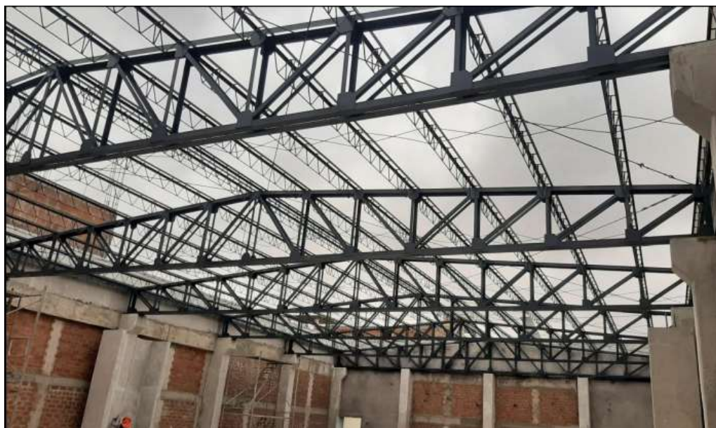
Fotografía 32. Viguetas metálicas (tijerales). Fuente: Elaboración propia
