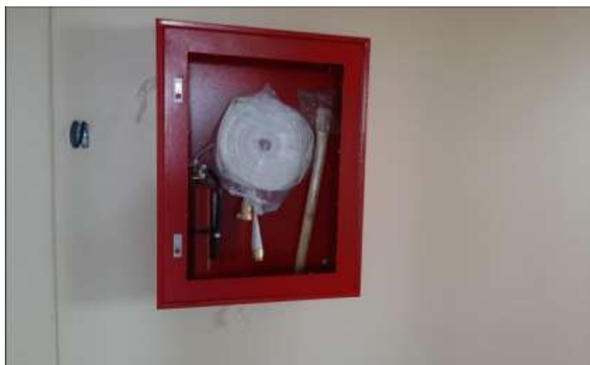
Fotografía 28. Instalación de gabinetes contraincendios Fuente: Elaboración propia
