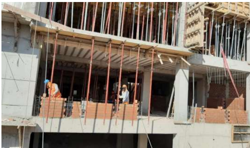
Fotografía 25. Muros de ladrillo KK sogá y cabeza. Bloque B. Fuente: Elaboración propia
