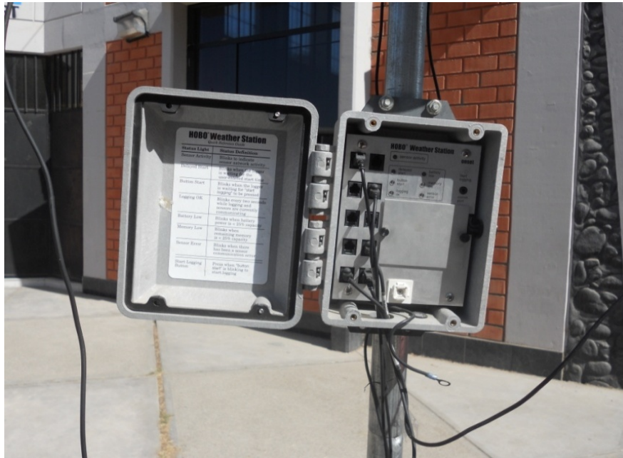
Figura 3.12: Memoria de almacenamiento de datos meteorológicos (humedad relativa en el interior del DST, y otros parámetros más) de la estación HOBO.
