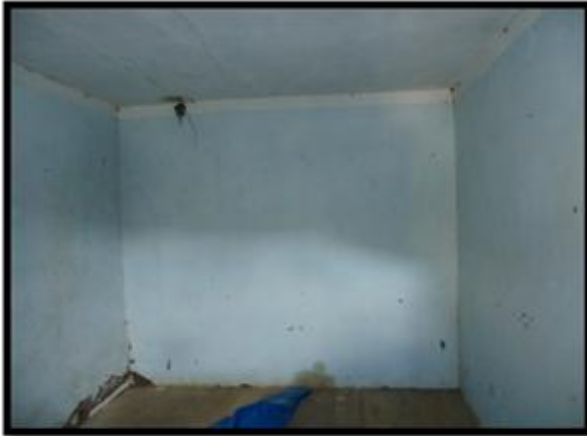
Cuarto vacío para medición de metano
