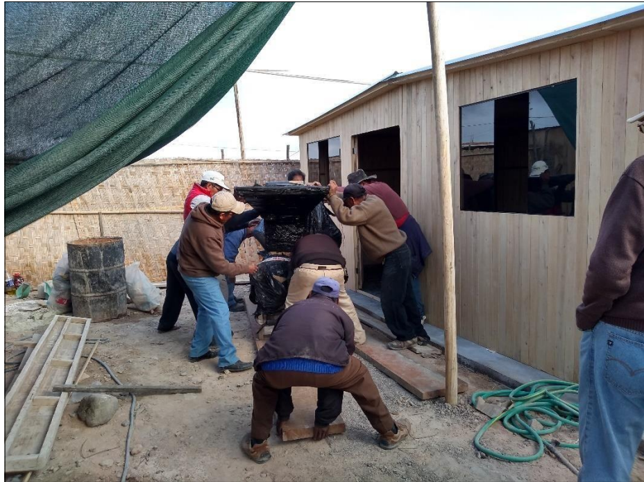
Figura 3. INIA-PINIA-APFTPS. Llegada e instalación de la moledora de tara.
