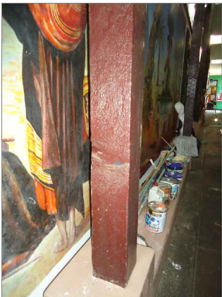
CARACTERISTICAS DE LAS PATOLOGIAS
