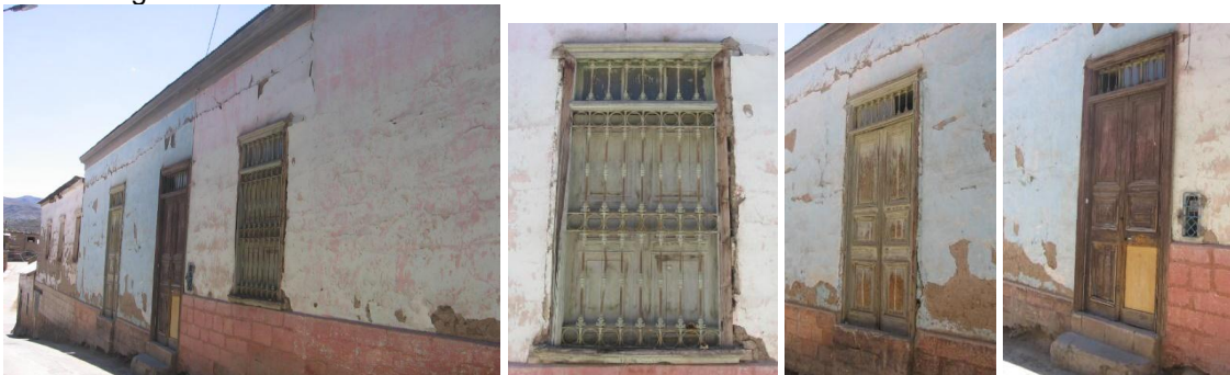
Vista del inmueble ubicado en la esquina anteriormente mencionada donde se distingue el trabajo en carpintería metálica y de madera, inmueble que merece un tratamiento de restitución
